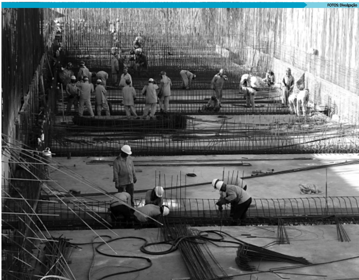
Translitorânea é considerada a maior obra do PAC II e vai beneficiar a população da Grande João Pessoa com abastecimento de água
